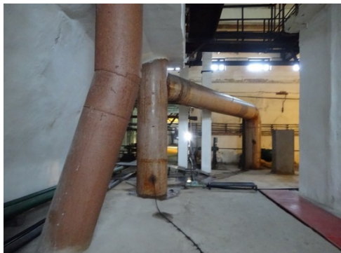
Karaganda Su浄水場の配管
